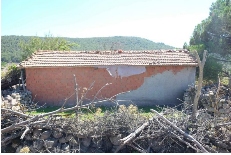
Foto 14: Yapı malzemesindeki deęişim
